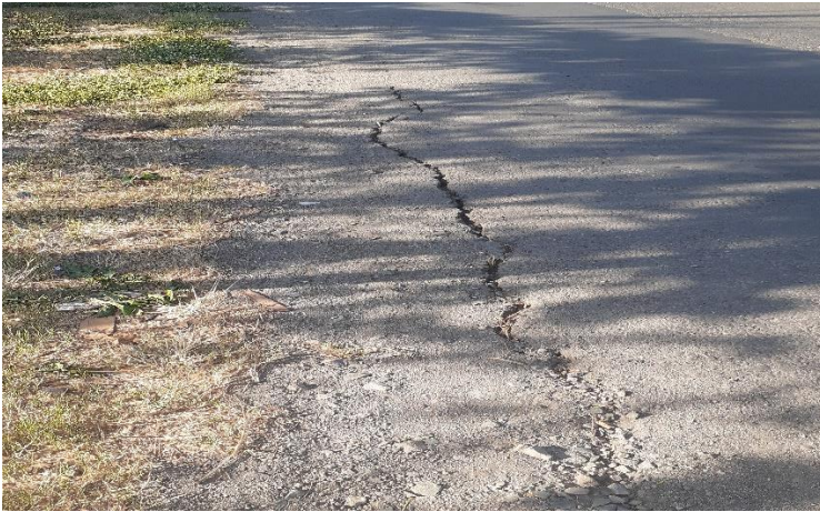
Kerusakan Retak Memanjang
