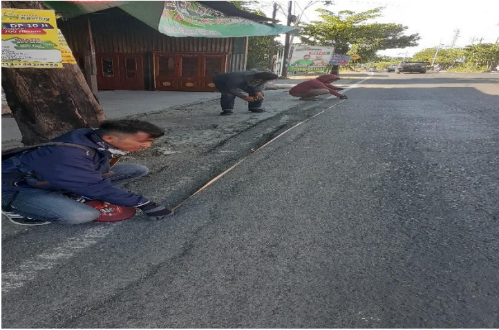
Dokumentasi saat pengukuran kerusakan jalan
