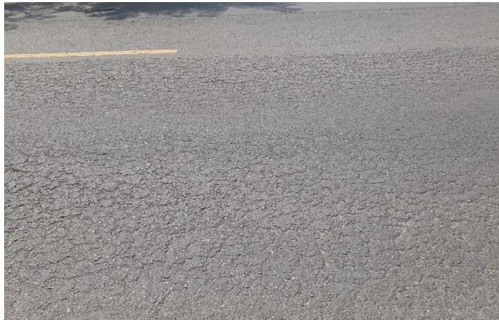
Kerusakan Retak Buaya
