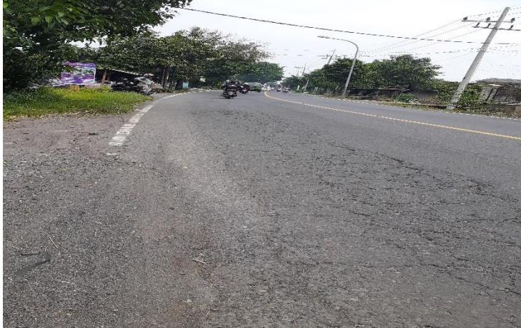
Kerusakan Retak Acak
