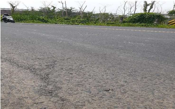
Kerusakan Retak Melintang
