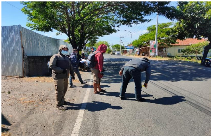
Dokumentasi saat pengukuran kerusakan jalan
