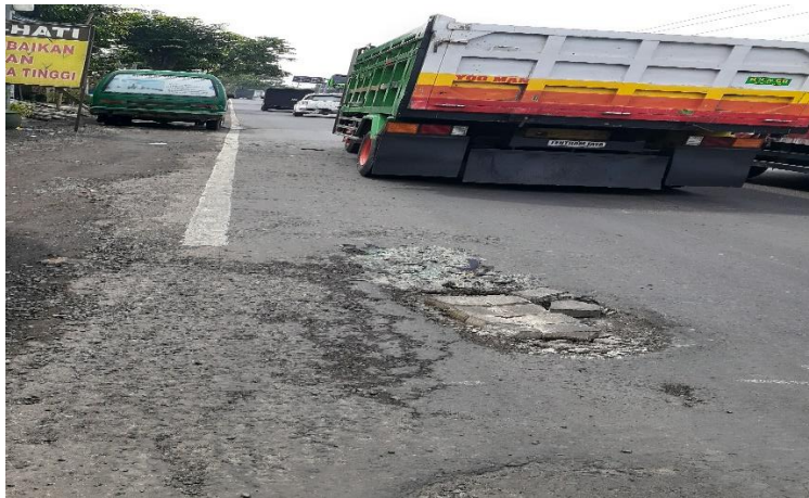
Foto Kerusakan Lubang
