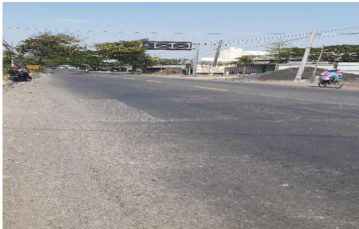
Foto Kerusakan Tambalan
