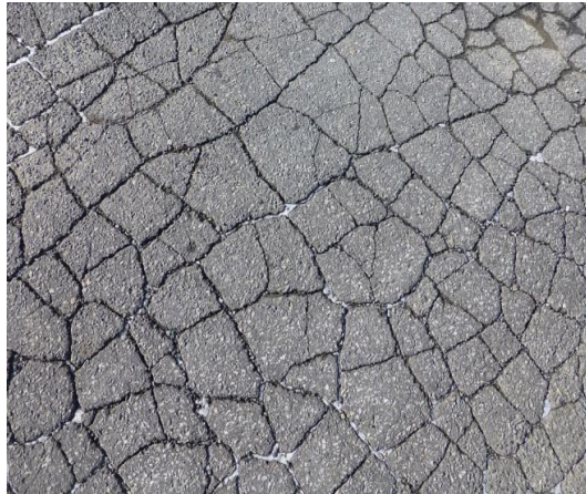
Gambar 2.3 Retak Kulit Buaya ( Alligator Cracking )
