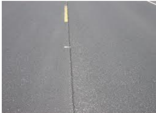
Gambar 2.5 Retak sambungan jalan ( lane joint cracks )
