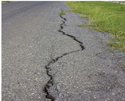
Gambar 2.4 Retak pinggir ( edge cracks ).
