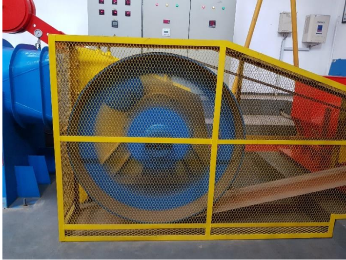
Pulley turbin saat beroperasi meneruskan putaran dari poros turbin ke generator
