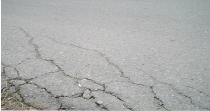
Gambar 2.7. : Retak Samping Jalan
