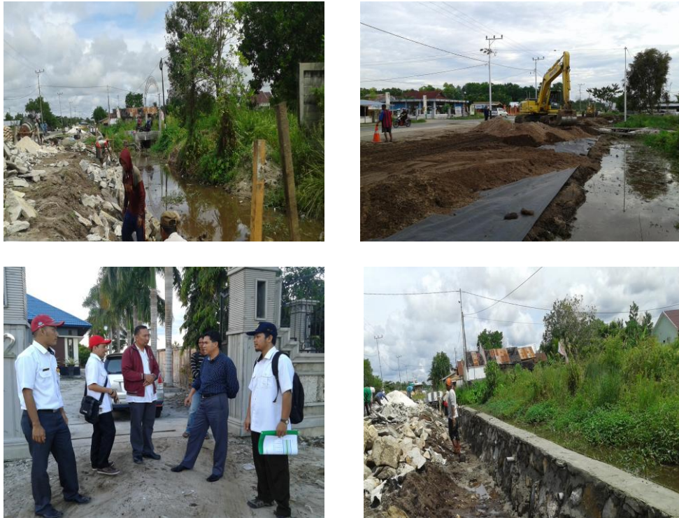
Gambar 1.3 Kondisi Jalan Saat Penanganan Sumber : Dinas Pekerjaan Umum Provinsi Kalimantan Tengah
