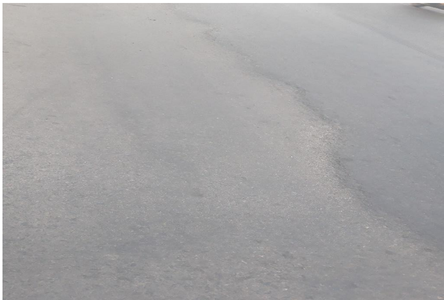
Dokumentasi Foto Kerusakan pada permukaan turun pada STA/KM 0+039
