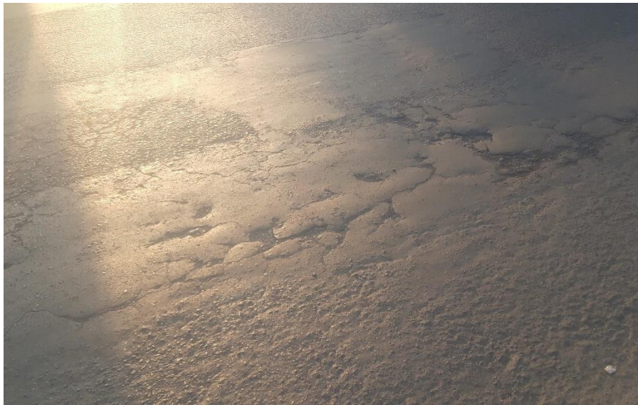
Dokumentasi Foto kerusakan pada retak kulit buaya pada STA/KM 0+127
