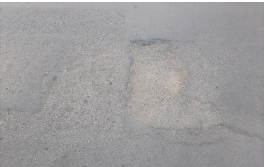
Dokumentasi Foto kerusakan pada lubang pada STA/KM 0+512
