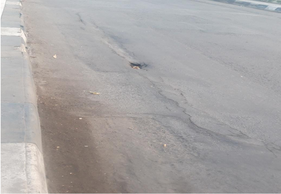
Dokumentasi Foto kerusakan pada ambblas pada STA/KM 0+017
