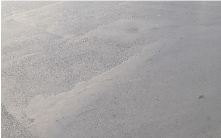
Dokumentasi Foto kerusakan pada bergelombang pada STA/KM 0+068
