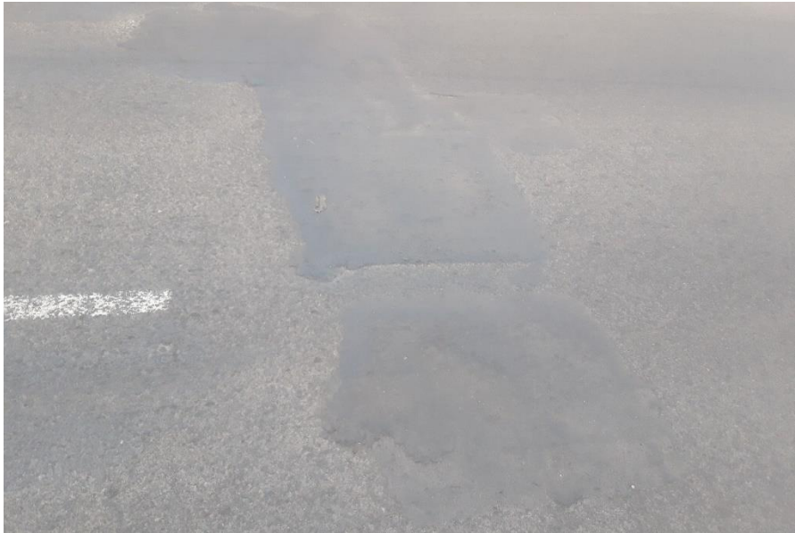
Dokumentasi Foto kerusakan pada tambalan pada STA/KM 0+010
