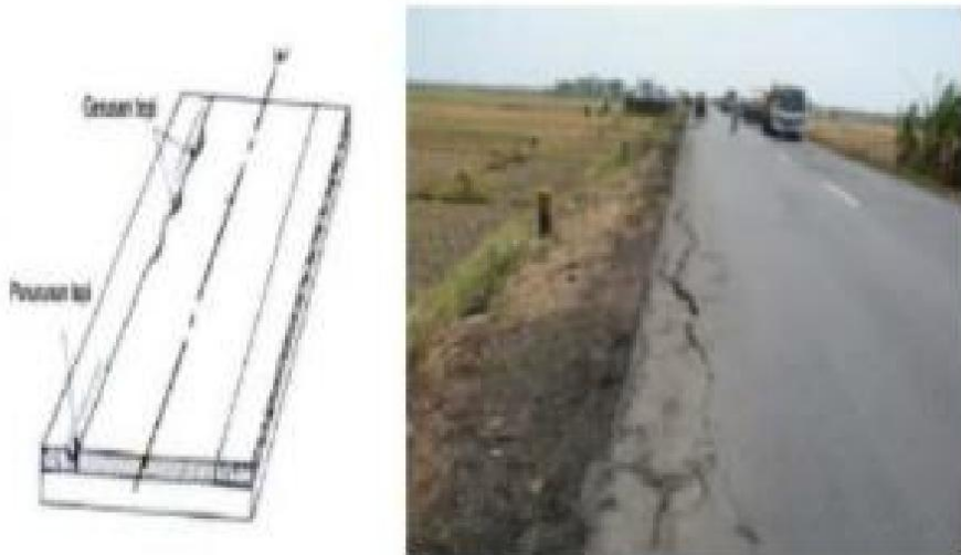
Gambar 2.17 Retak Samping Jalan ( Edge Cracking ) Sumber : Bina Marga (1983)
