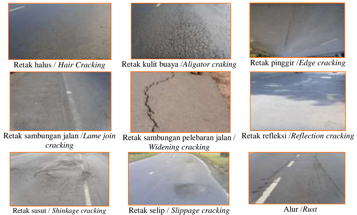
Gambar 1.1. Jenis Kerusakan Jalan di ruas jalan Batas Kalbar – Kudangan – Penopa Sumber : Dinas Bina Marga Kabupaten Lamandau
