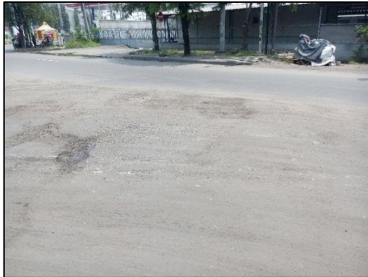
Gambar 2.8. Kerusakan Lepas (Dokumentasi)
