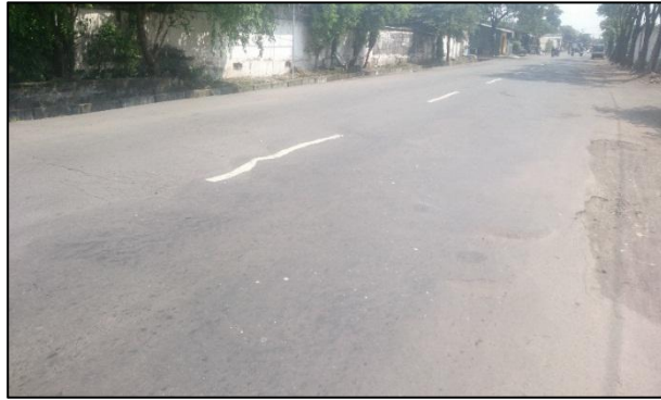
Gambar 2.10. Kerusakan Gelombang (Dokumentasi)
