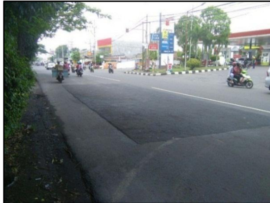
Gambar 2.4. Kerusakan Tambalan (Dokumentasi)
