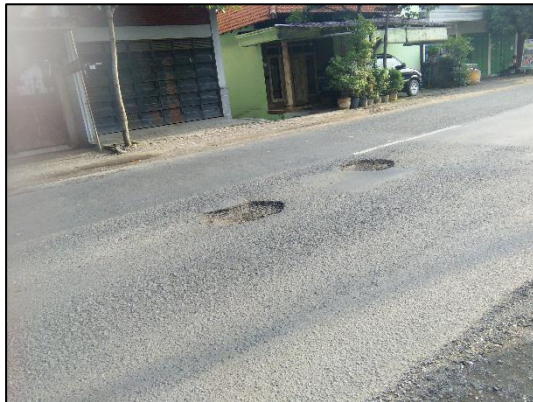
Gambar 2.9. Kerusakan Lubang (Dokumentasi)
