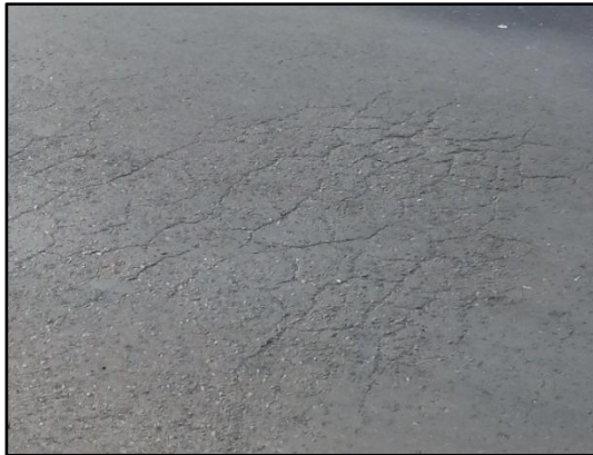
Gambar 2.5. Kerusakan Retak Buaya (Dokumentasi)
