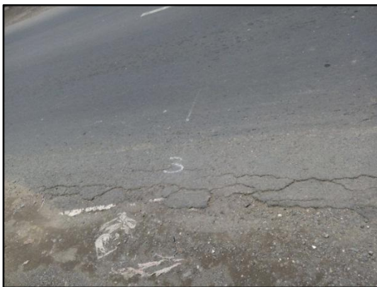
Gambar 2.6. Kerusakan Retak Pinggir (Dokumentasi)
