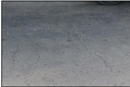
Gambar 2.7. Kerusakan Retak Persegi (Dokumentasi)
