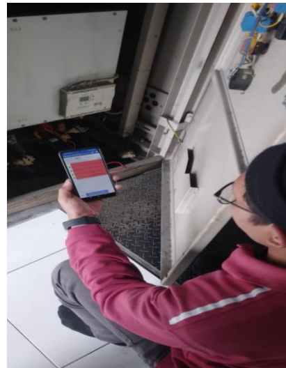
Gambar 5. 4 Pengukuran Pompa Banjir No 2
