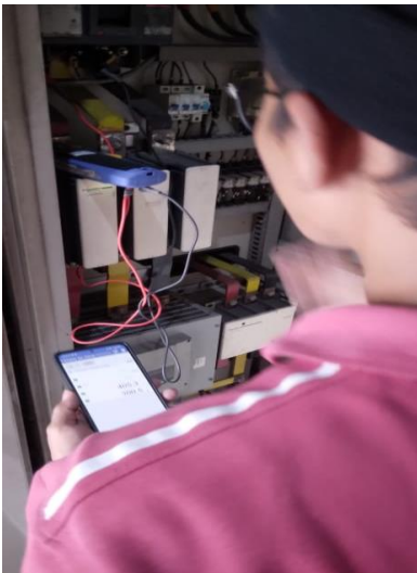
Gambar 5. 3 Pengukuran Pompa Banjir No 2
