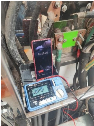
Gambar 5.4 Pengukuran tahanan isolasi antar fasa kabel 1
