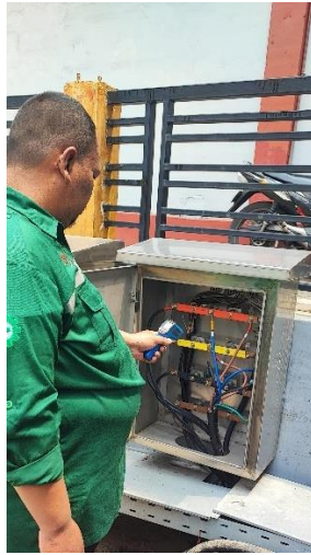
Gambar 5.2 Pengukuran Suhu pada junction box
