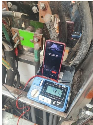
Gambar 5.5 Pengukuran tahanan isolasi antar fasa kabel 2
