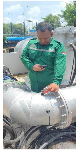
Gambar 5.3 Pengukuran tingkat kebisingan pompa
