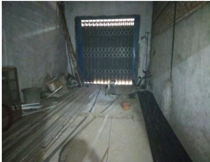
Stasiun Kerja Pemotongan
