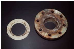
d) korosi celah
