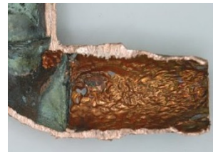
c) korosi erosi
