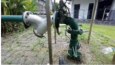
Pipa dari sumur
