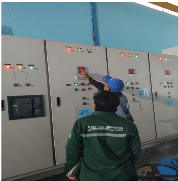
Foto Panel Kontrol Motor Induksi
