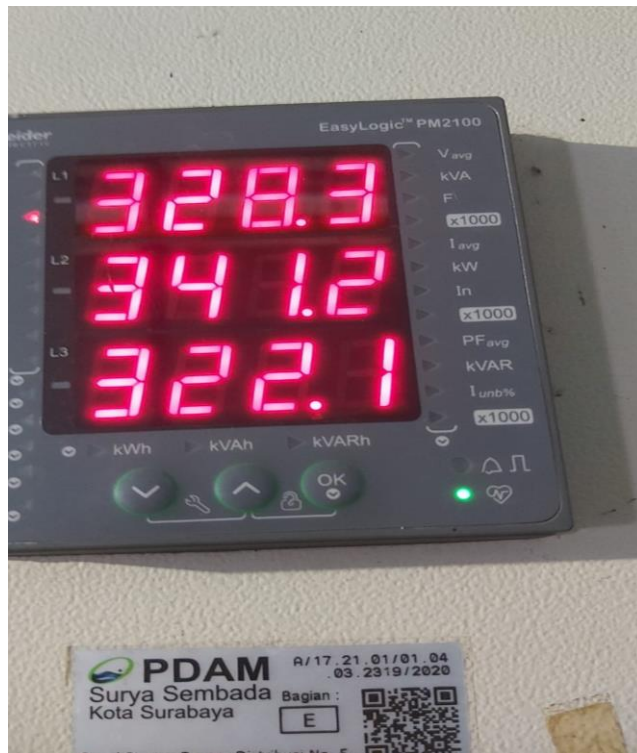
Foto Data tegangan Pada Panel Kontrol
