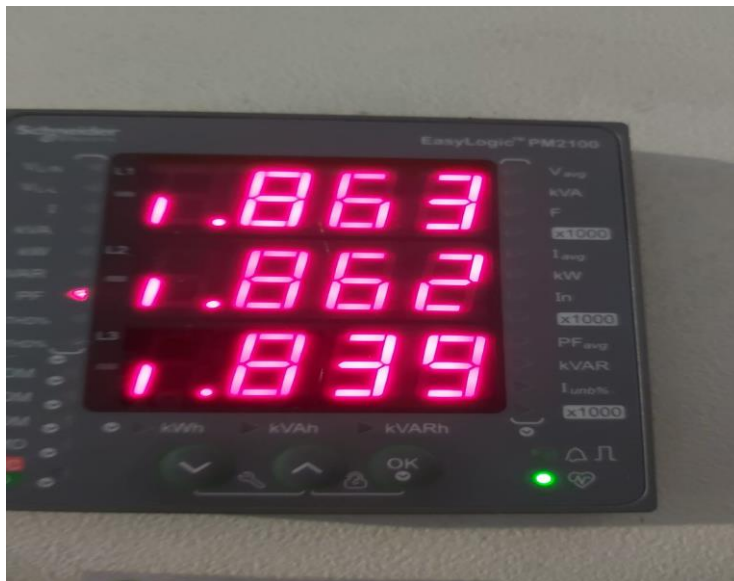
Foto Data Cosphi Pada Panel Kontrol
