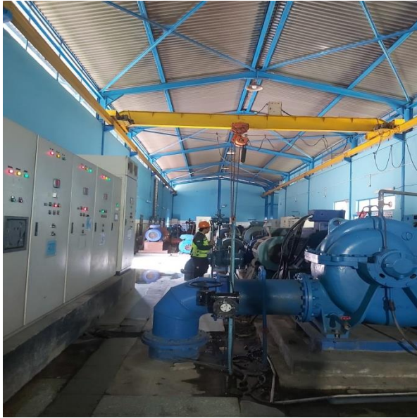
Foto Ruang Tempat Motor Induksi Dan Pompa
