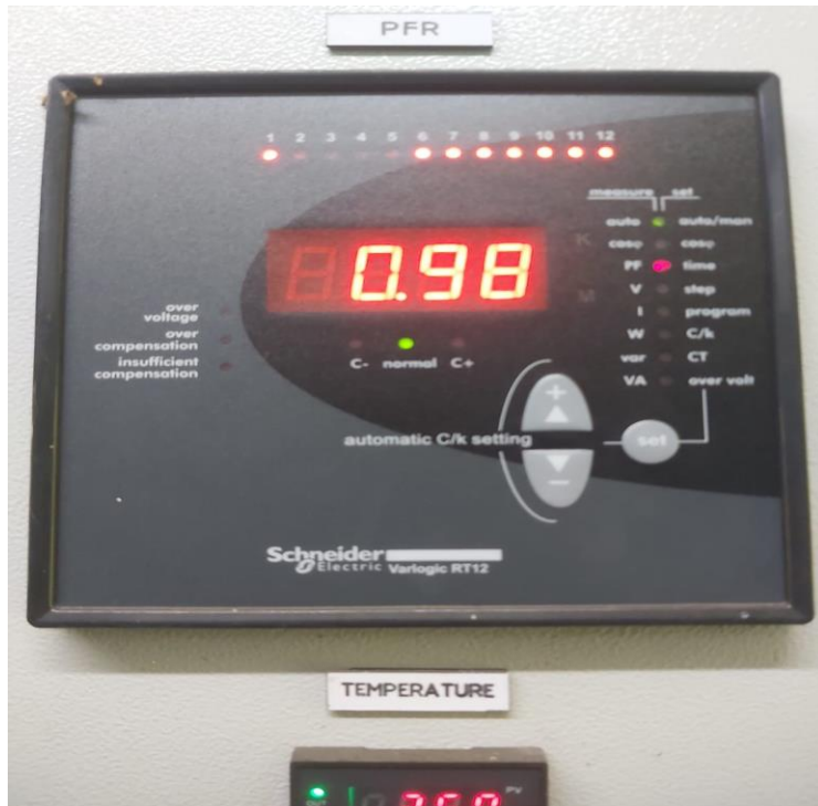
Foto Data Cosphi pada Panel Kontrol
