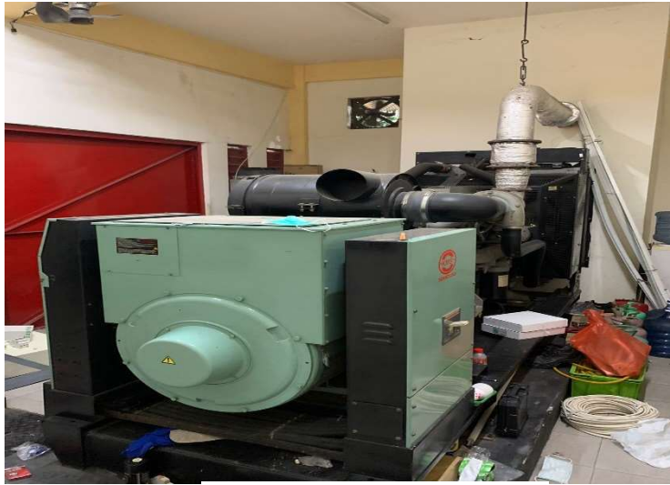
Gambar Genset 500kVA
