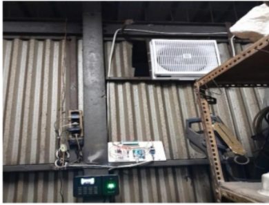
Gambar 4. 2 Implementasi alat pada ruangan
