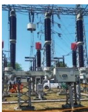
Gambar 4 PMT Bay Line Surabaya Selatan 1 Gardu Induk 150 kV Rungkut.
