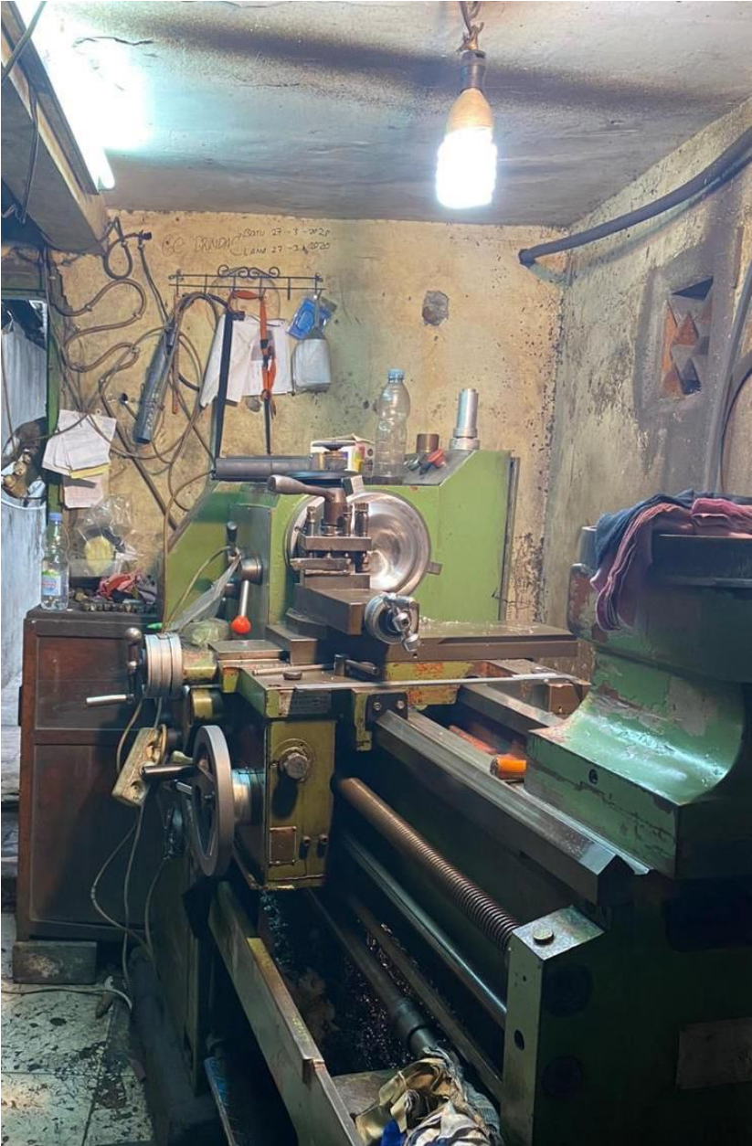
Lampiran 2. Kondisi Ruangan Mesin Setelah Penambahan lampu
