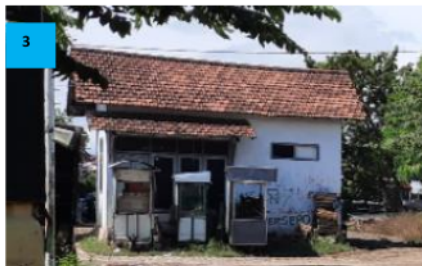
Gambar 7 Kondisi Bangunan Pos Pantau Stasiun Ponorogo
