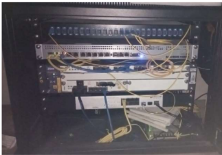
Gambar 5. Instalasi Router dan OLT di POP
