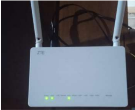
Gambar 4. Instalasi ONT di rumah pelanggan
