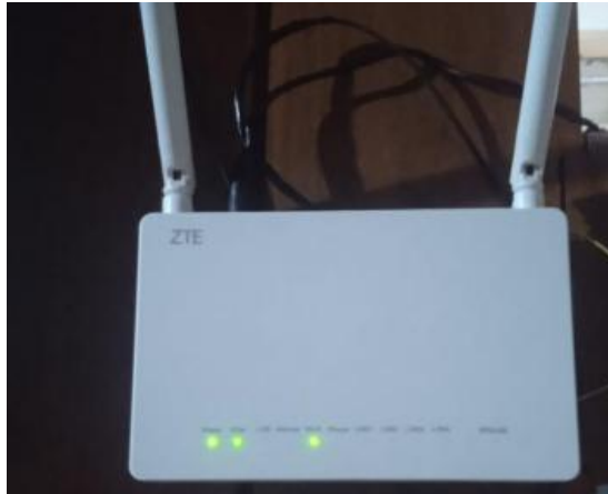
Gambar 4. Instalasi ONT di rumah pelanggan
