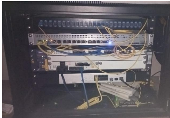
Gambar 5. Instalasi Router dan OLT di POP
