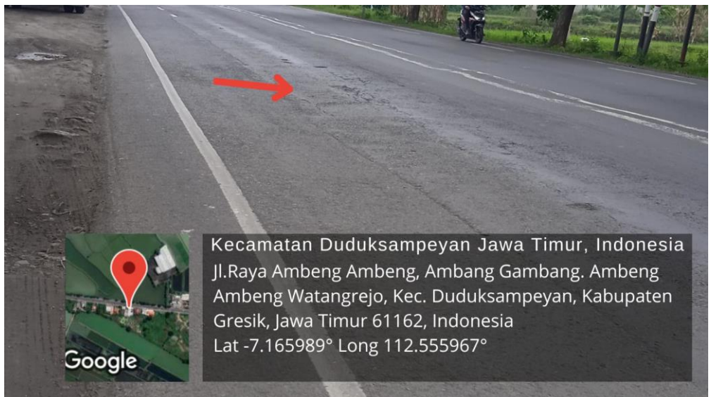
Gambar Lampiran 1. f Kondisi jalan yang Retak (Sumber : Dokumentasi Pribadi)
