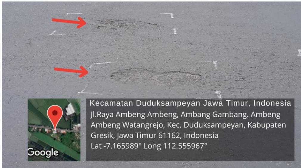
Gambar Lampiran 1. e Ditemukan beberapa titik jalan dengan kondisi berlubang (Sumber : Dokumentasi Pribadi)
