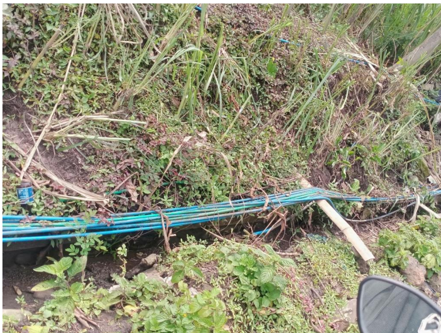
Gambar 9 Foto Survey Lokasi Sampel Sambungan Rumah
