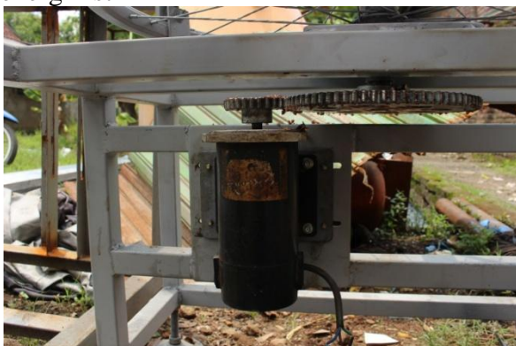
Gambar 5. Generator yang sudah terpasang
