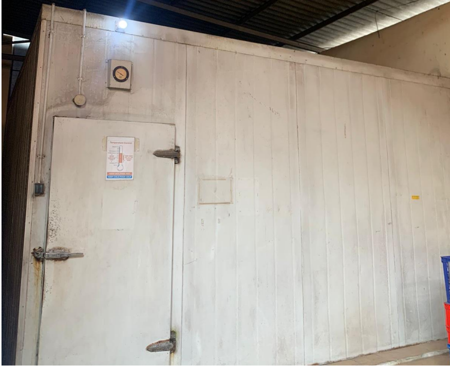
Lampiran 4 Cold Storage Yang Lama
