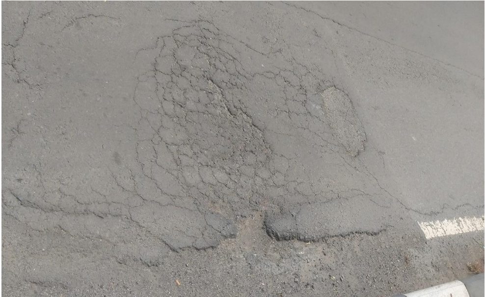
Kondisi kerusakan retak kulit buaya pada STA 2 + 100 – 2 + 200
