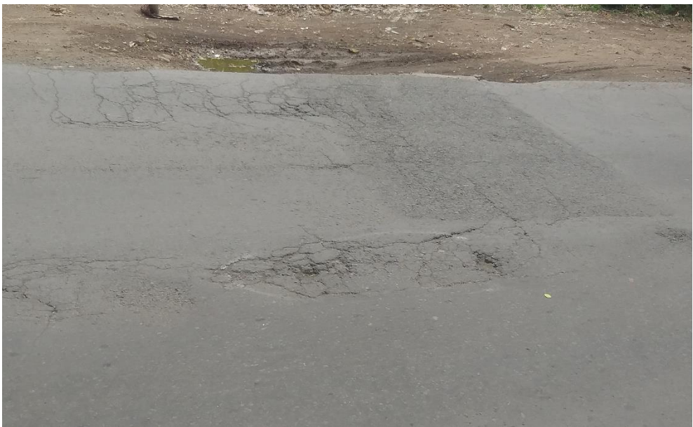
Kondisi jalan yang mengalami kerusakan Retak Pinggir pada STA 1+500 – 1+600
