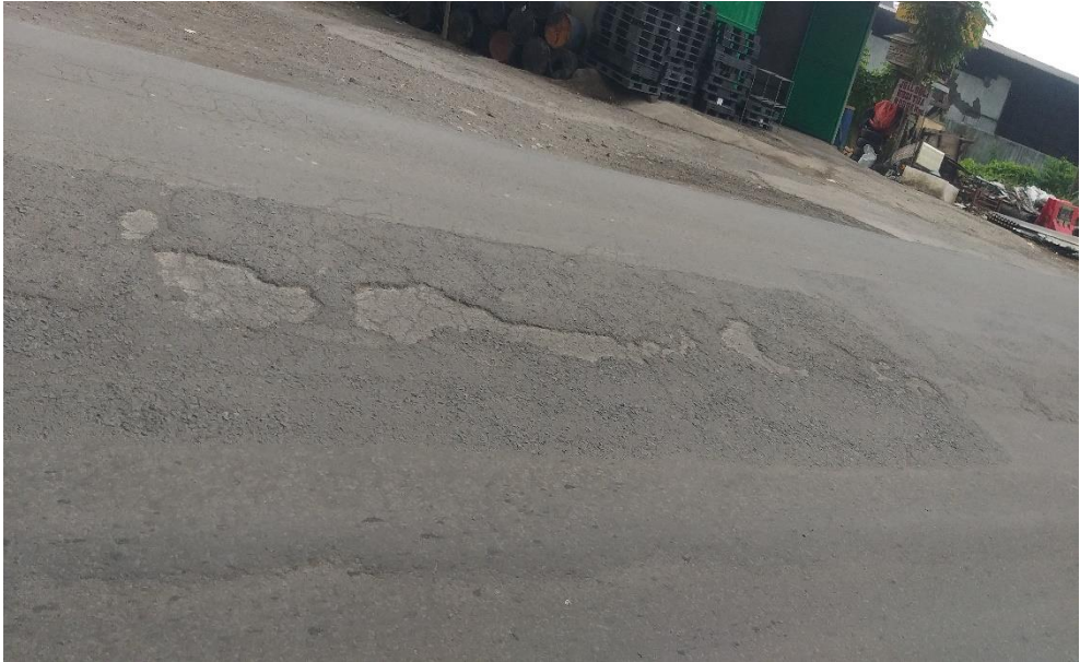
Kondisi kerusakan tambalan pada STA 1 + 000 – 1 + 100
