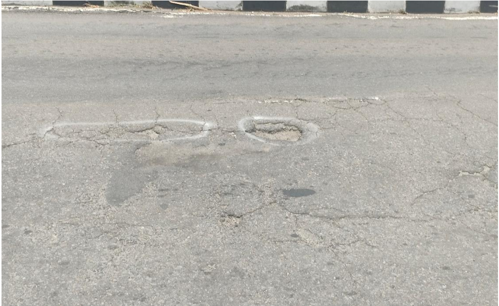
Kondisi kerusakan lubang dan retak-retak pada STA 2 + 600 – 2 + 700
