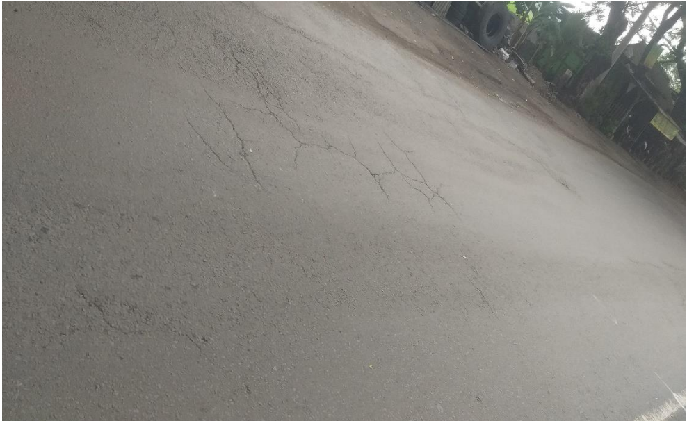
Kondisi kerusakan retak memanjang & melintang pada STA 0 + 100 – 0 + 200
