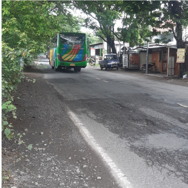
Gambar Lampiran 1: Kondisi Jalan Raya Baureno
