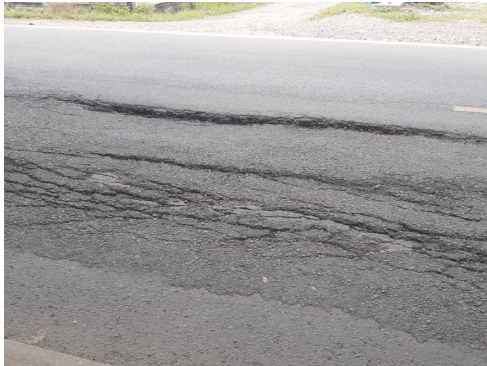
Gambar Lampiran 4: Kondisi Jalan Raya Baureno Amblas
