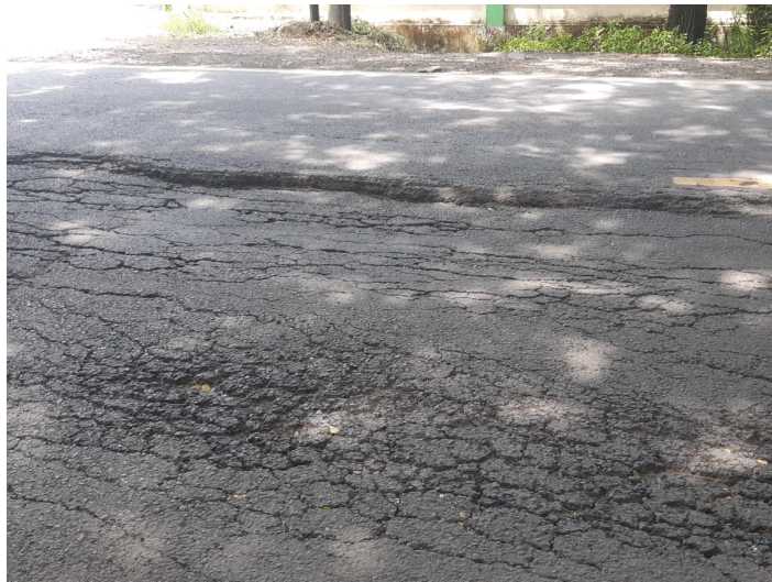
Gambar Lampiran 8: Kondisi Jalan Raya Baureno
