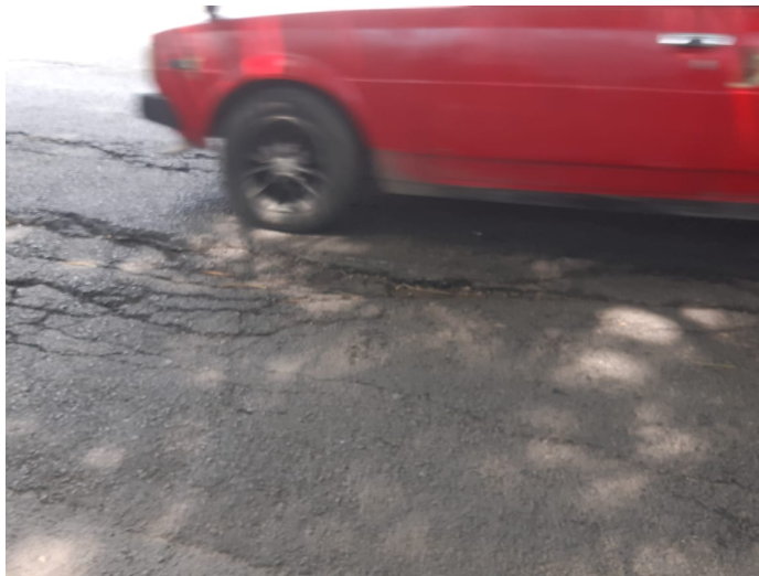
Gambar Lampiran 7: Kondisi Jalan Raya Baureno
