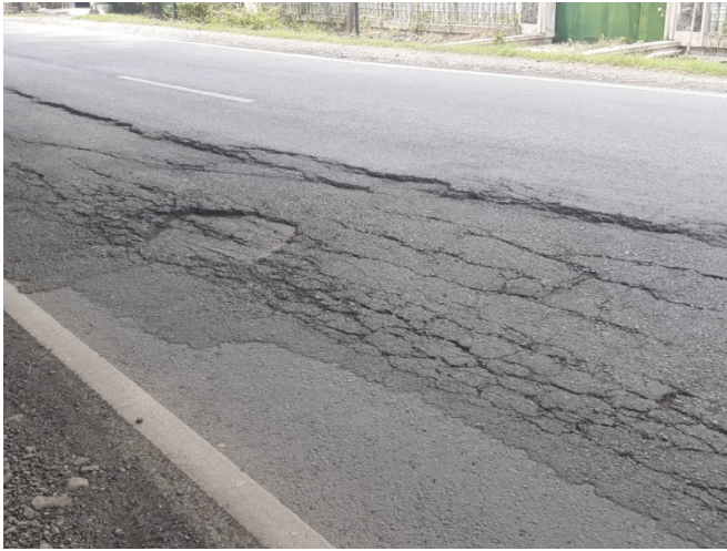
Gambar Lampiran 5: Kondisi Jalan Raya Baureno Retak Memanjang dan berlubang
