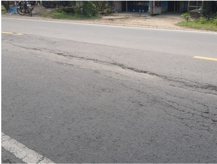
Gambar Lampiran 3: Kondisi Jalan Raya Baureno Retak Miring
