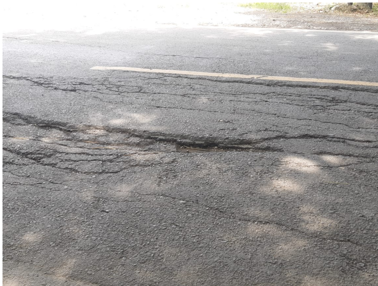
Gambar Lampiran 6: Kondisi Jalan Raya Baureno Retak Slip
