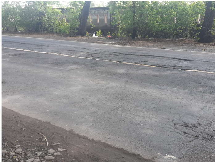
Gambar Lampiran 2: Kondisi Jalan Raya Baureno Retak Memanjang
