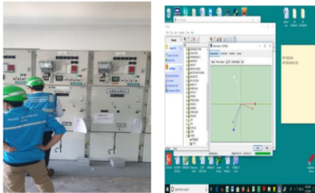
Gambar 4.6 Pengujian Kalibrasi kWh Meter
