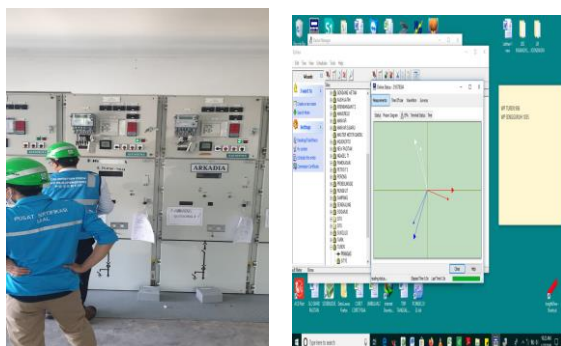
Gambar 4.6 Pengujian Kalibrasi kWh Meter
