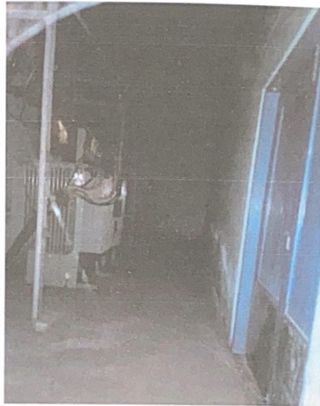
Lampiran 3 Dokumentasi transformator IPAL PT. SIER
