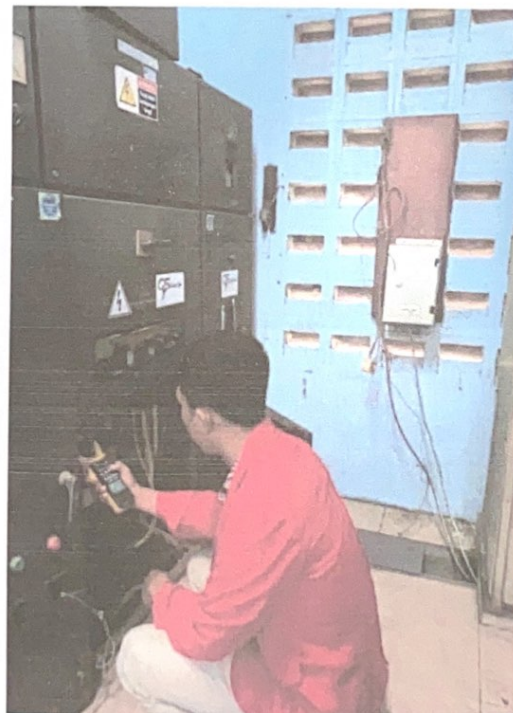
Lampiran 4 Dokumentasi pengukuran arus dan tegangan di panel MDP
