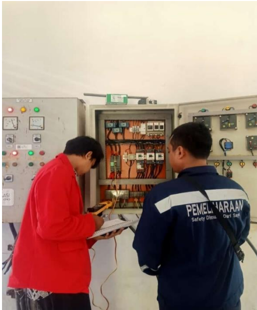
Gambar Pengukuran Pada Panel SDP 1
