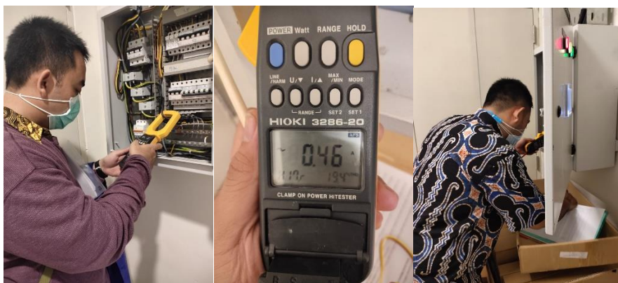
Foto Pengukuran pada panel SDP menggunakan clamp meter HIOKI
