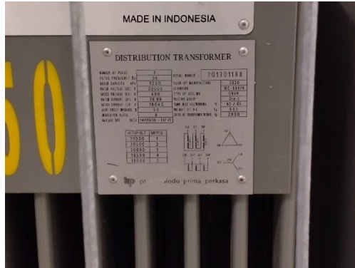
Foto Spesifikasi Transformator pada Gedung Kuliah Bersama
