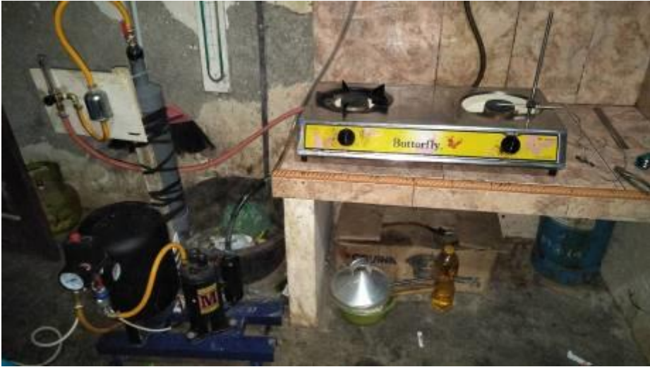
Foto rangkaian kompresor, tabung permurnian, dan kompor biogas.
