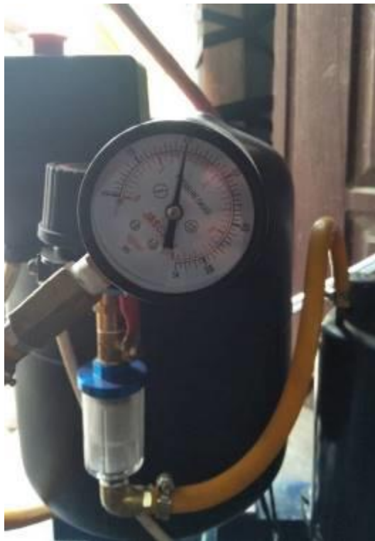
Foto Rangkaian Pressure gauge kompresor Biogas
