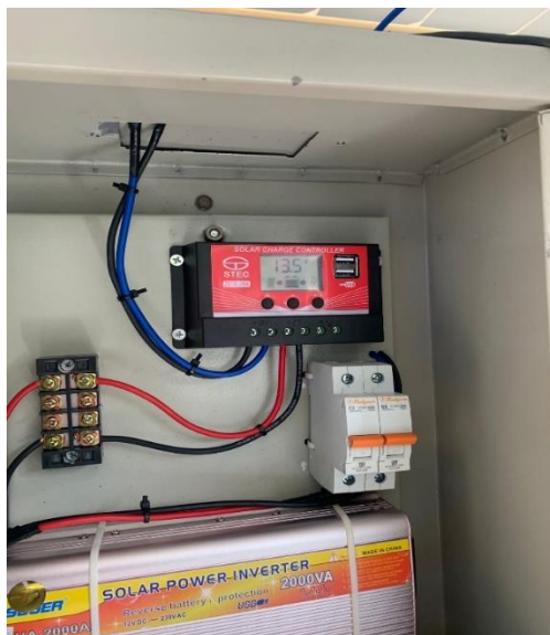
Rangkaian Panel Surya dengan SCC dan Inverter
