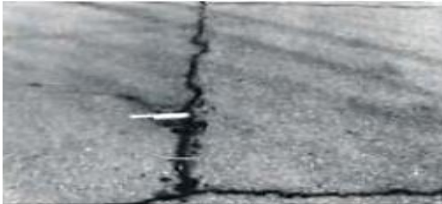
Gambar 2.3: Retak Sambung (Joint Reflec Cracking)
