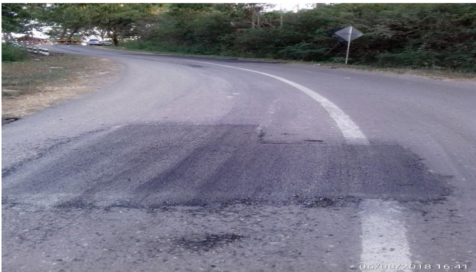
Sumber : Satuan kerja pelaksanaan jalan nasional Labuan Bajo
