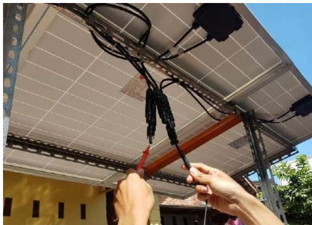
Pengukuran Tegangan Terbuka Panel Surya
