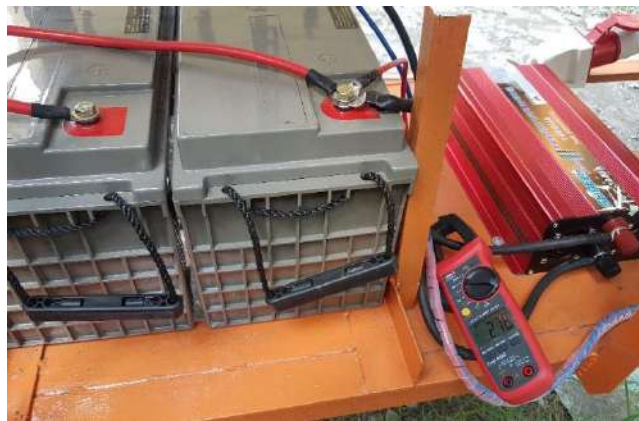
Pengukuran Arus Pada Baterai
