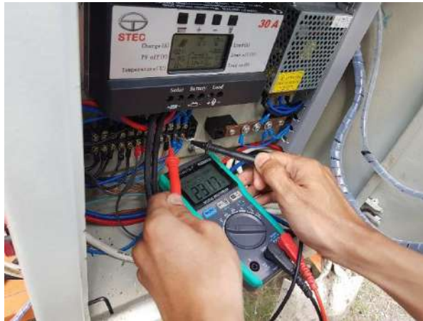
Pengukuran Arus Inverter
